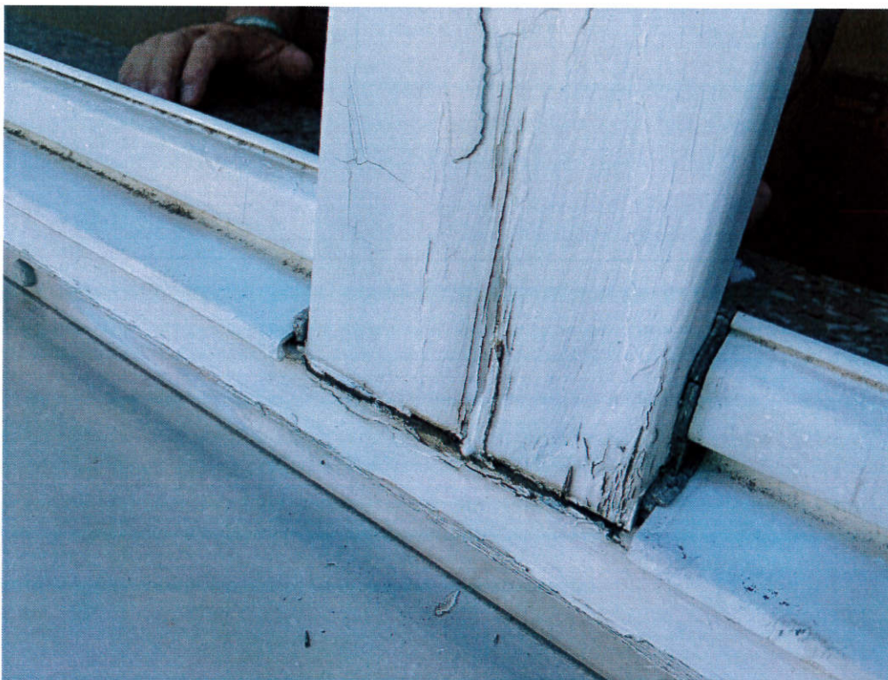
Bildbeispiel - Fenster haben massive Holzschäden
