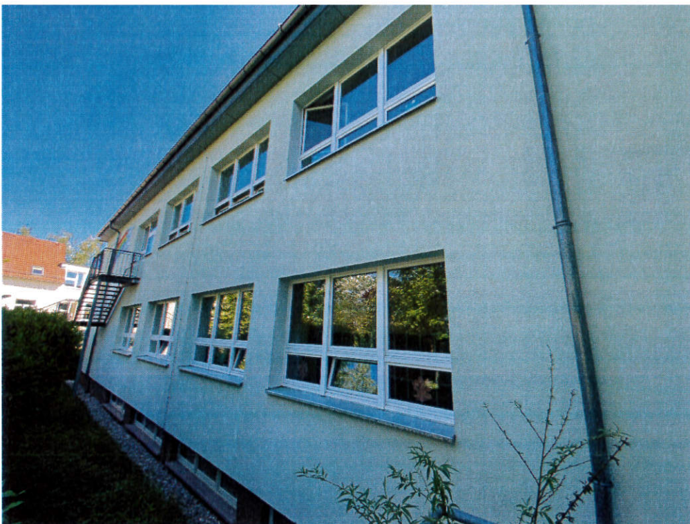
Außenansicht Gebäude Seite Hauptstraße – geschädigte Fenster
