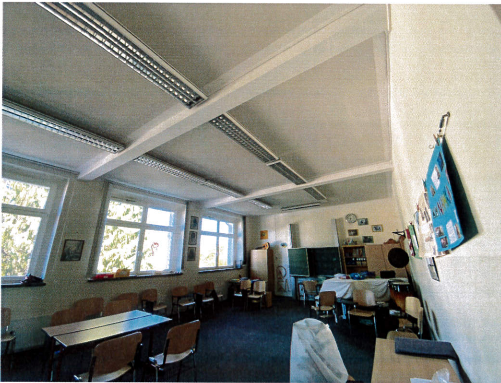
alte Beleuchtung und Beispiel für zu erneuerndes Zimmer
