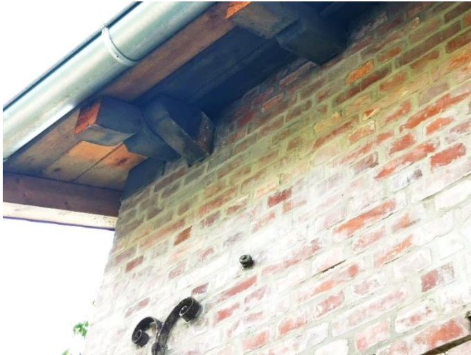
Abbildung 14: Kotspuren am Dachtrauf
